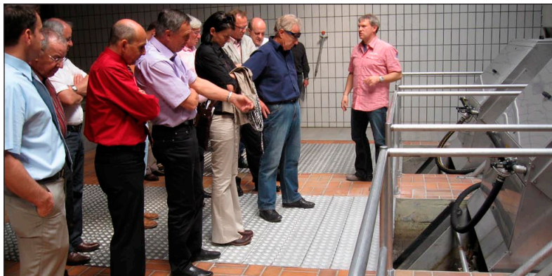
DAS FORUM AVT besuchte bereits zum zweiten Mal das Zillertal. Hier beim Abwasserverband AIZ in Strass.
